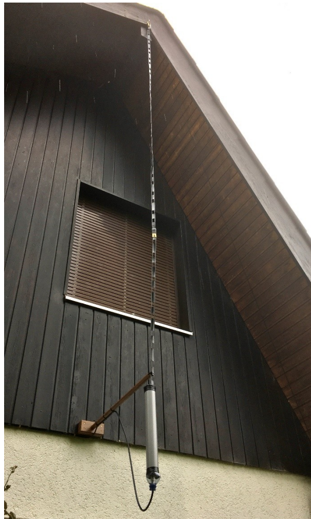
Abbildung 9 Antenne am Dachfirst montiert am QTH in Wisen (SO).
