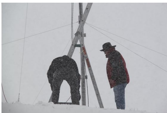
Antennenabbau nach dem Contest. Als ob die Rohre nicht schon kalt genug wären, es gab noch mächtig Neuschnee dazu.
